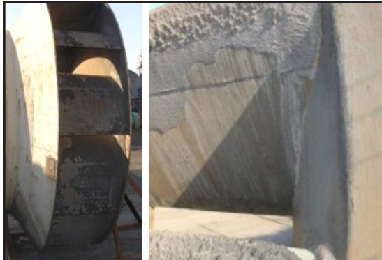
Build-up on fan blades
